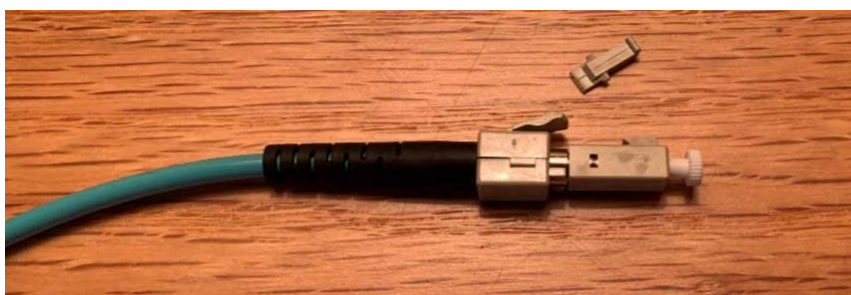
プラスチック製 LC コネクタのラッチ破損の例
